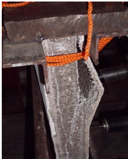
Gambar 5.23. Tipe kerusakan akibat uji tekan panel dinding polystyrene PST1_250
