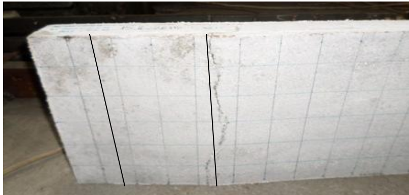
Gambar 5.9. Pola retak panel dinding BPSL2_250
